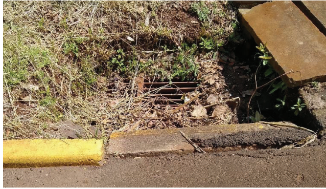
Figura 49. Modelo de boca de lobo instalada na área urbana, porém com acumulo de materiais na sua entrada
